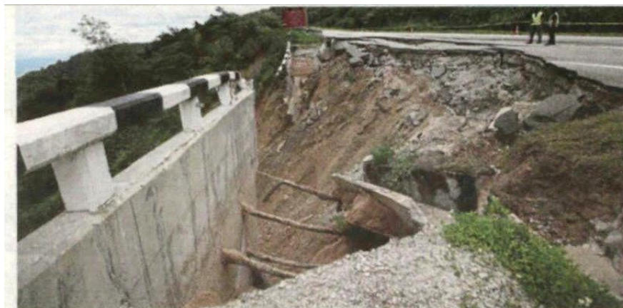
Tanah runtuh di Kilometer 43.95 Jalan Simpang Pulai-Blue Valle, menyebabkan laluan di Seksyen 43.9 ditutup, kelmarin.
